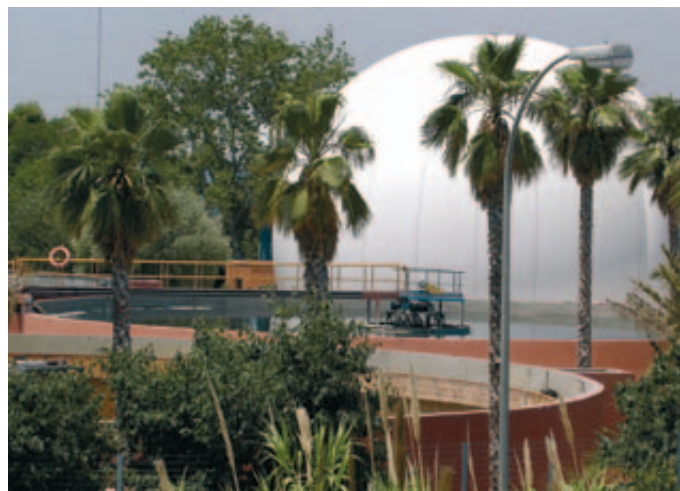
El Plan Nacional de Calidad de las Aguas 2007 – 2015 prevé la construcción de mil nuevas EDAR, con una mejora del 15% en el consumo de energía.
